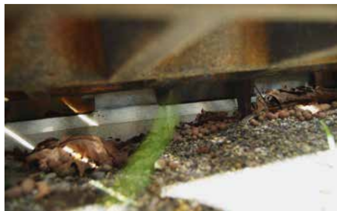
Genügender Zwischenraum unter der Abdeckung
