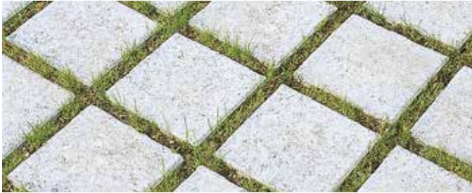
Versickerung durch aufgeweitete Fugen (Rasenfuge)
