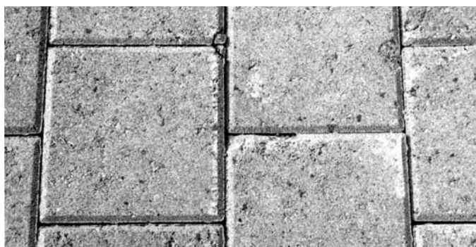
Beispiel von Kantenabplatzungen infolge fehlenden Fugenmaterials
