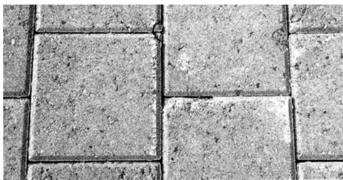
Beispiel von Kantenabplatzungen infolge fehlenden Fugenmaterials
