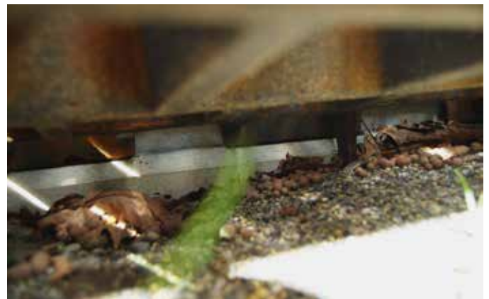
Genügender Zwischenraum unter der Abdeckung
