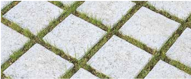
Versickerung durch aufgeweitete Fugen (Rasenfuge)
