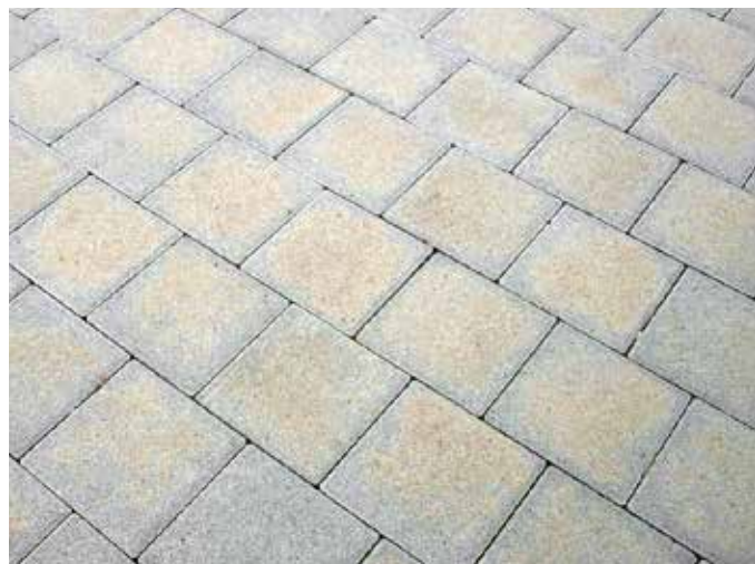
Pflasterstein mit gelb-braun-Verfärbungen
