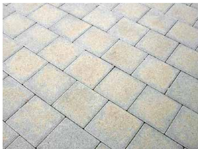
Pflasterstein mit gelb-braun-Verfärbungen
