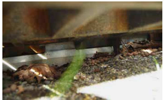
Genügender Zwischenraum unter der Abdeckung
