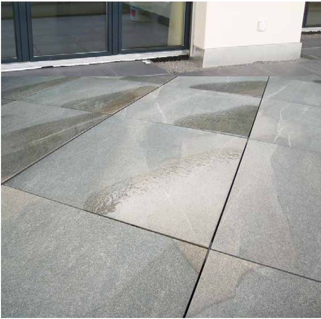
Bild 5: Wasser in Ecken infolge Oberflächenspannung
