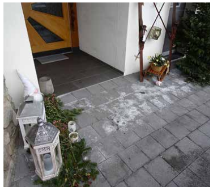
Kalkausblühungen auf jungen Betonpflastersteinen im Eingangsbereich.
