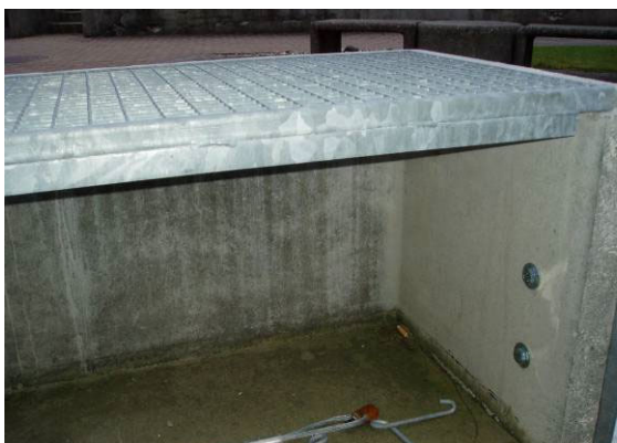
Bild 39: Verstärkte Gitterrostkante gegen die Hauswand
