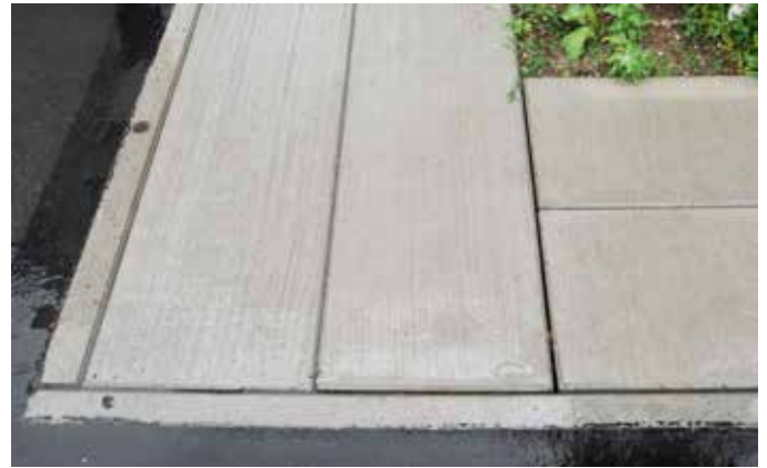
Wasserzufuhr durch Fugen
