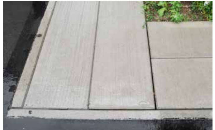
Wasserzufuhr durch Fugen
