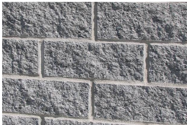
Bild 38: Läuferband mit Lager- und Stossfugen
