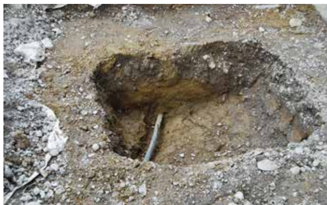
Werkleitungen stören das Wachstum der Baumwurzel
