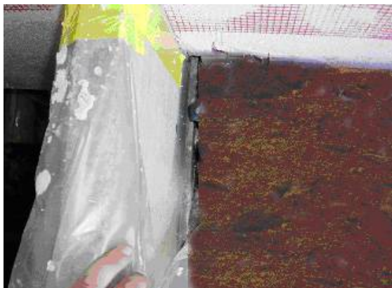
Bild 37: Trennfolie zwischen Hinterfüllung und Lichtschacht
